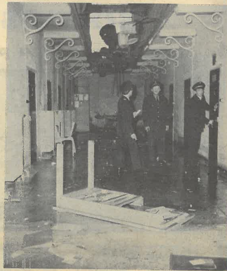
Les gardiens constatent l'étendue des dégâts qui sont cependant moins graves qu'on aurait pu le supposer. (Photo « A.N. »)
